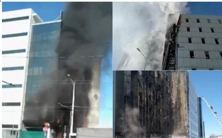
Рис. 1. Возгорание фасадной системы торгово-офисного центра «Скала» (г. Самара, 2021 г.)
