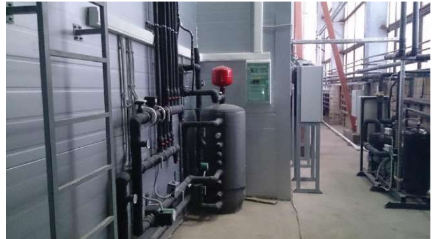
Стенд теплотехнических испытаний инженерного оборудования
