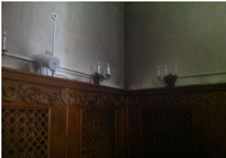
Рис. 2. Следы «закопчения» нижней части наружной стены храма
